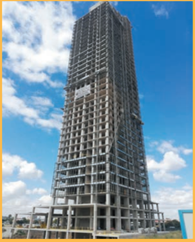
SOL CEPHE I. AŞAMA
